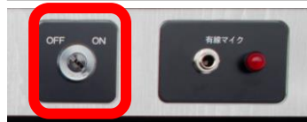
AV ラックキー差込口
